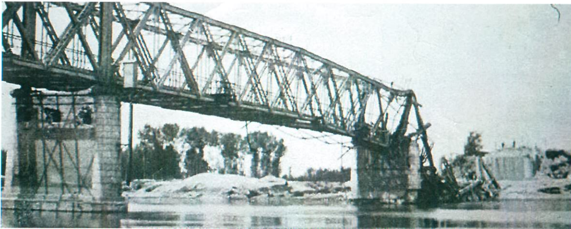
Il ponte della Becca semidistrutto e reso inutilizzabile dai bombardamenti alleati nel 1944. Dopo la fine della guerra venne ricostruito e riaperto nel 1950
